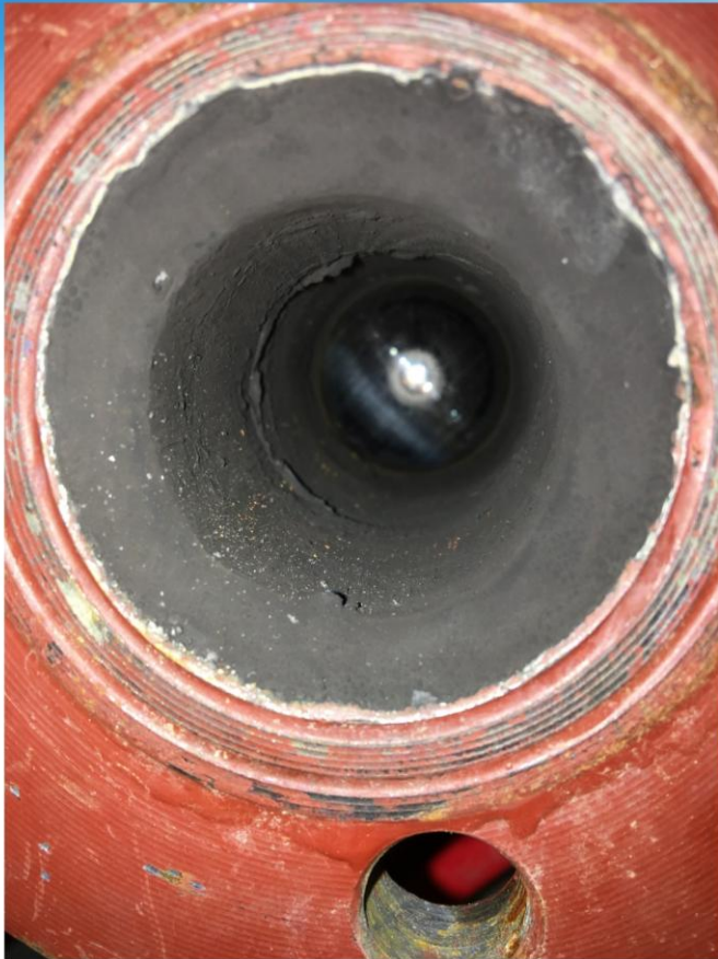
Instalacja MPEC woda uzdatniona z dodatkiem inhibitora korozji
