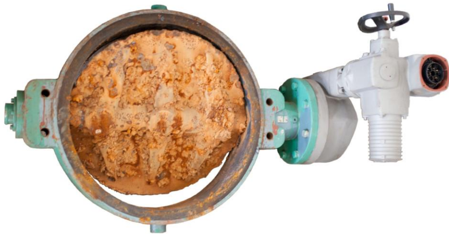
Zarośnięta Zasuwa DN500
