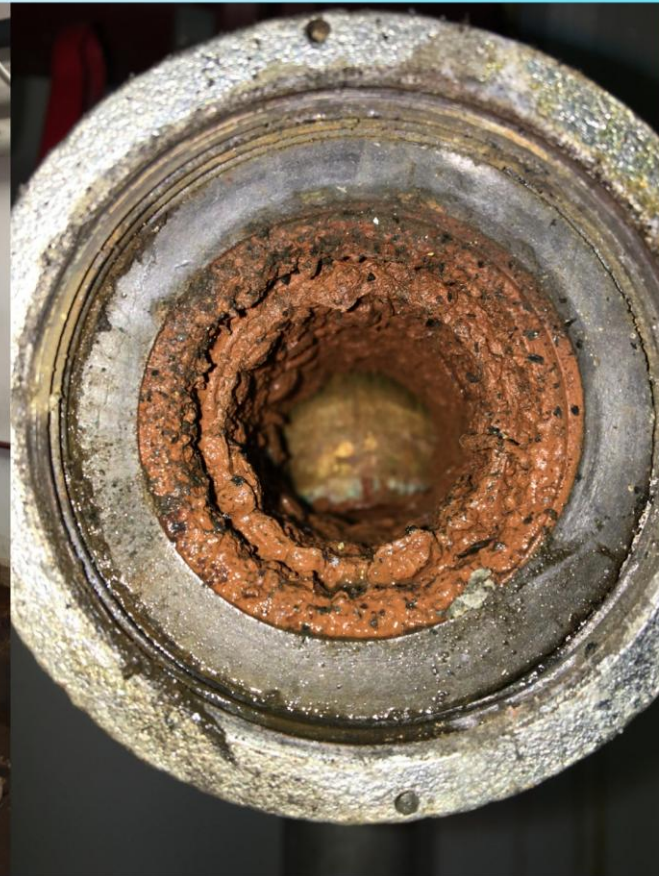
Instalacja zimnej wody poddanej podgrzaniu poprzez wymiennik ciepła
