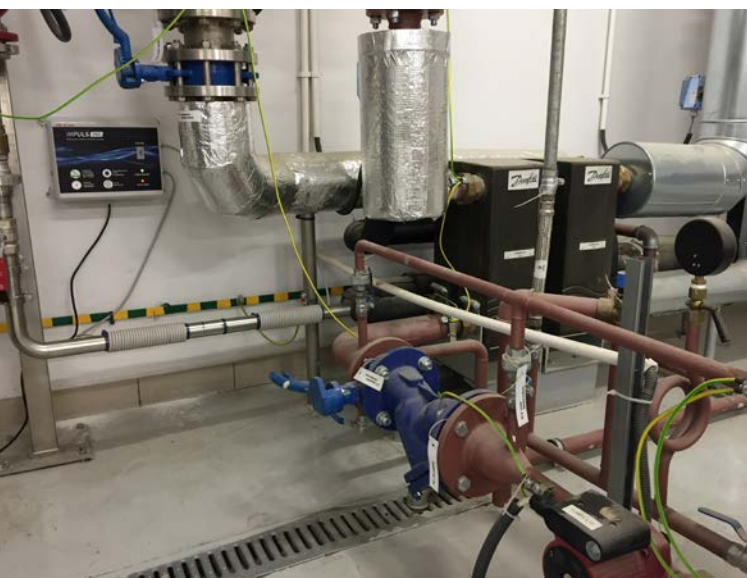
zabezpieczenie płytowych wymienników ciepła Danfoss
