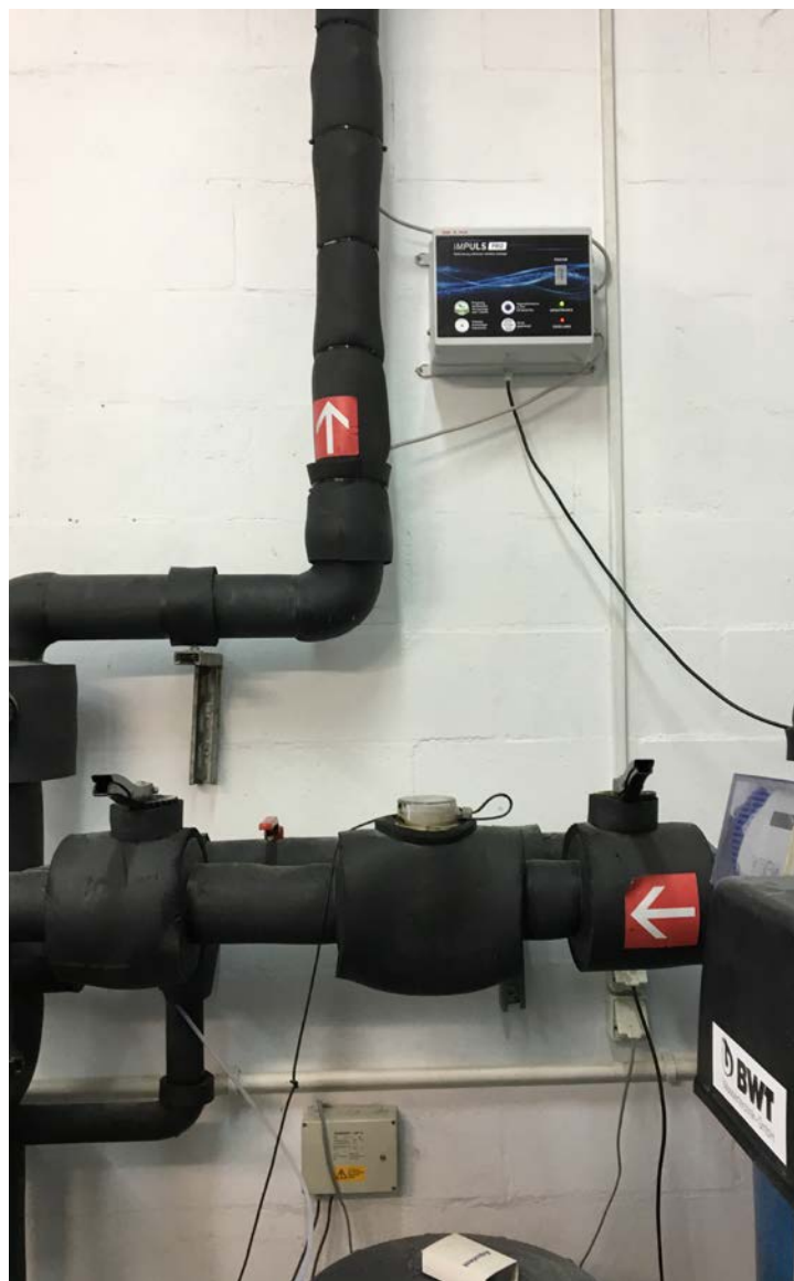
zabezpieczenie wody użytkowej w centrum handlowym
