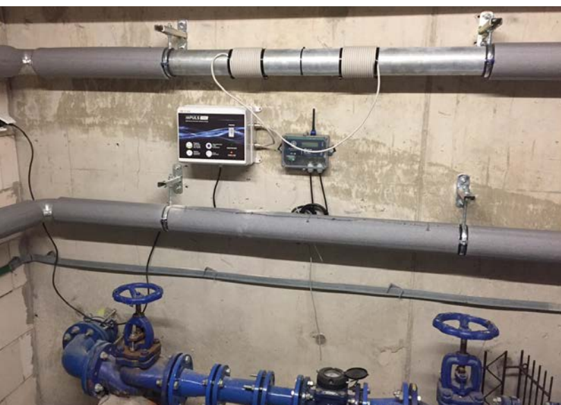
zabezpieczenie wody użytkowej w budynku wielorodzinnym
