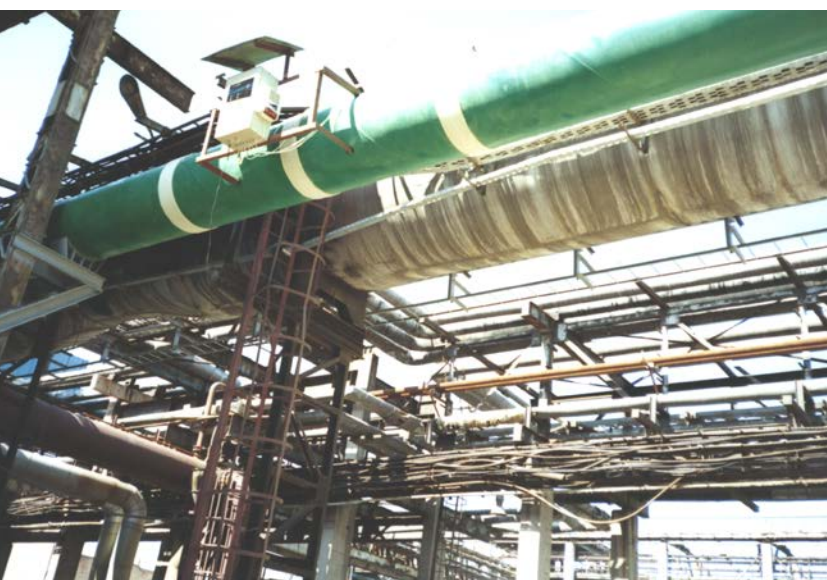
zabezpieczenie instalacji wody chłodniczej w przemyśle chemicznym
