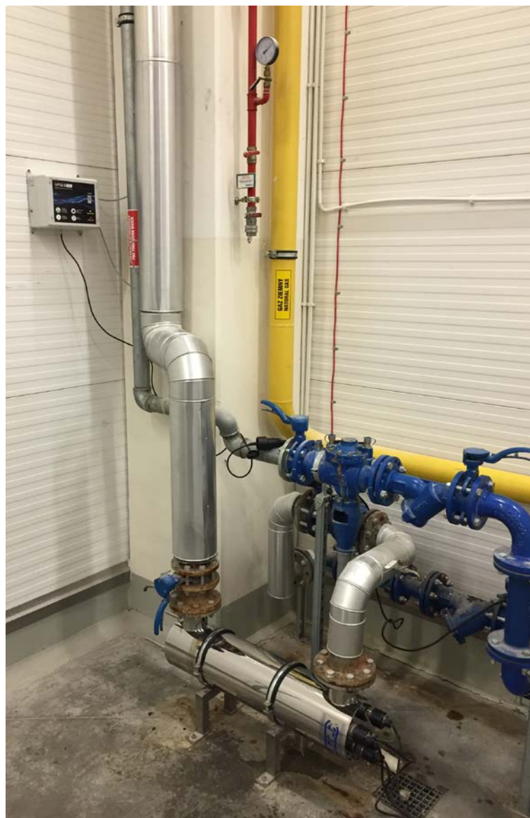
zabezpieczenie instalacji ciepłej wody użytkowej (CWU)
