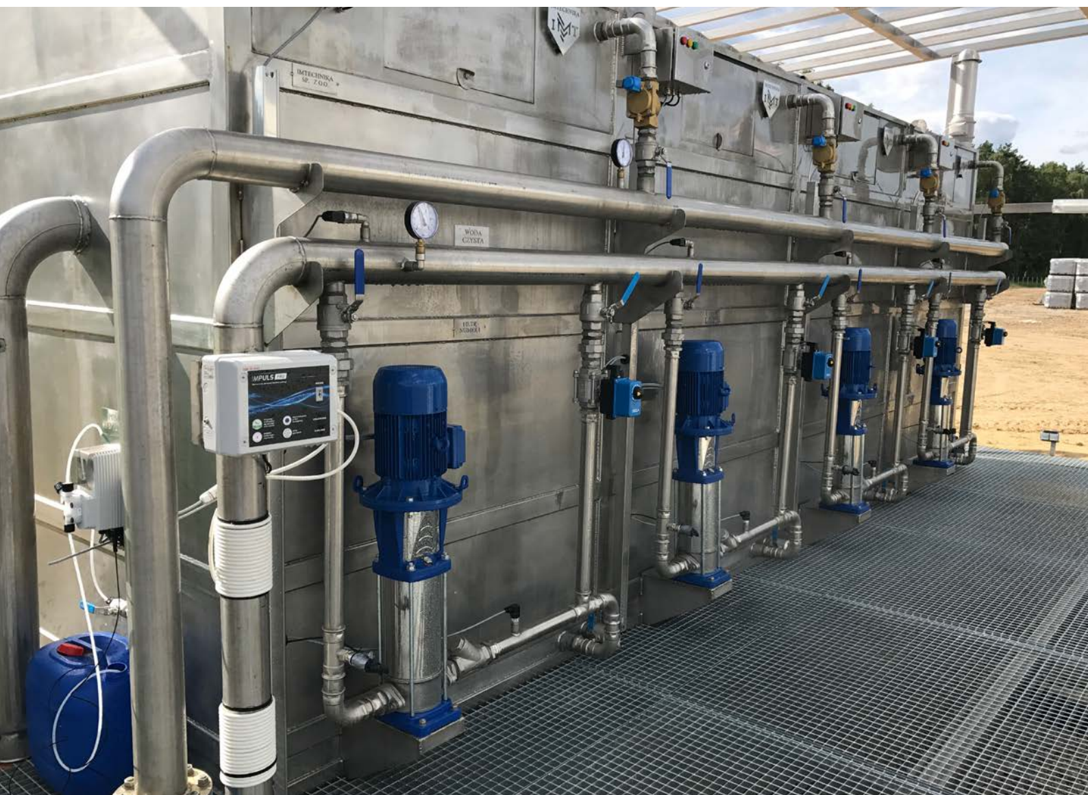
zabezpieczenie technologii w stacji uzdatniania wody
