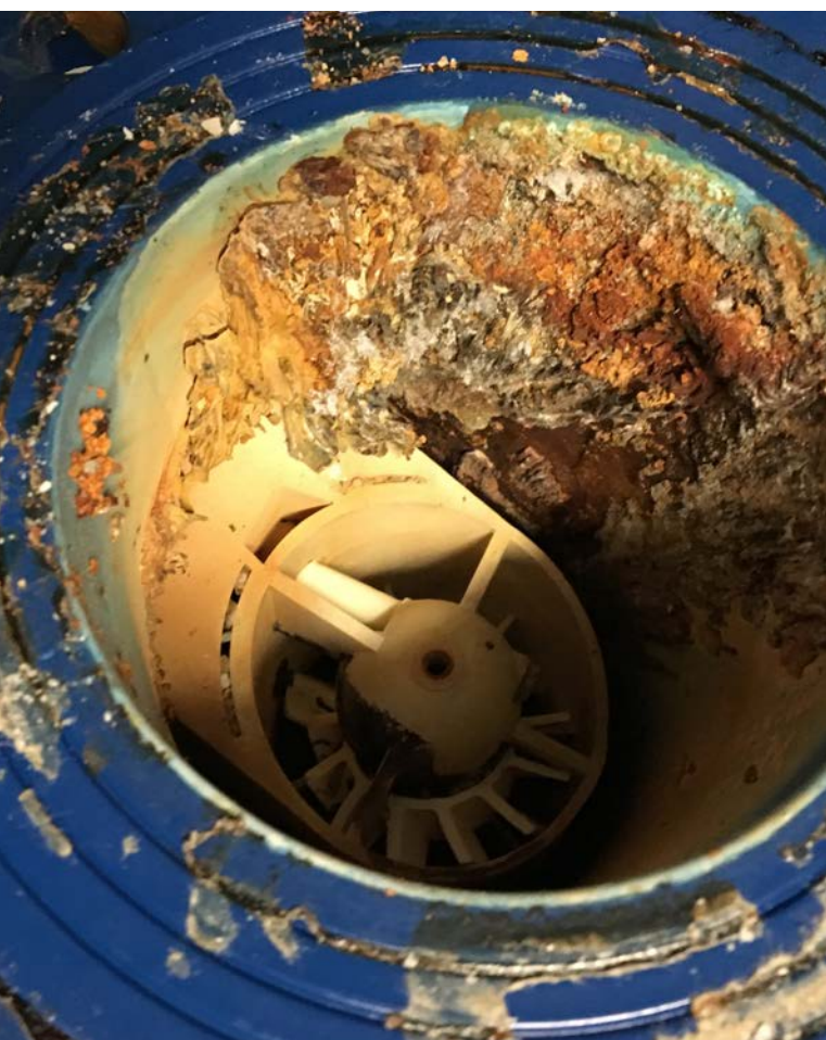
Uszkodzony licznik przepływu wody
