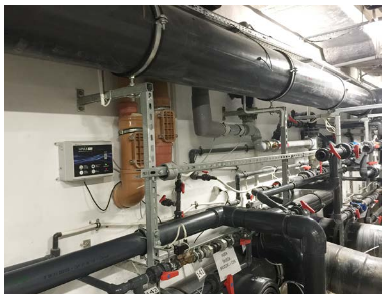
zabezpieczenie technologii wody na basenie publicznym
